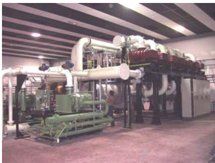
Le groupe de pompage
